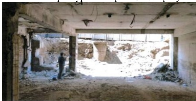
Рис. 2.3 Узлы сопряжения отдельных колонн с ригелями в уровне подвала. Стрелками показаны арматурные стержни, подвергнутые коррозии
